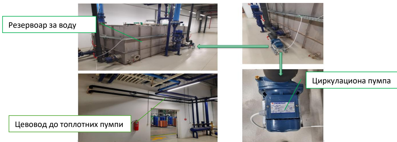
Слика 4: Резервоар за воду са циркулационом пумпом Оригиналне фотографије
